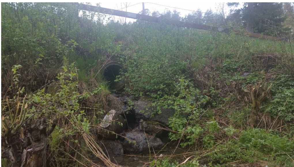
Dagvattenkylvert under Trädgårdsångarvägen
